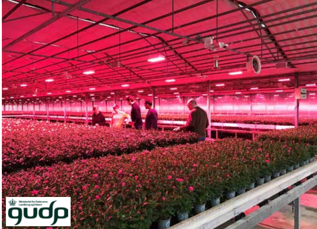
Nye LED-lamper i væksthusegartneriet RosaDanica kan dæmpes og lyset dermed justeres efter planternes behov, samtidig med, at der spares energi.
